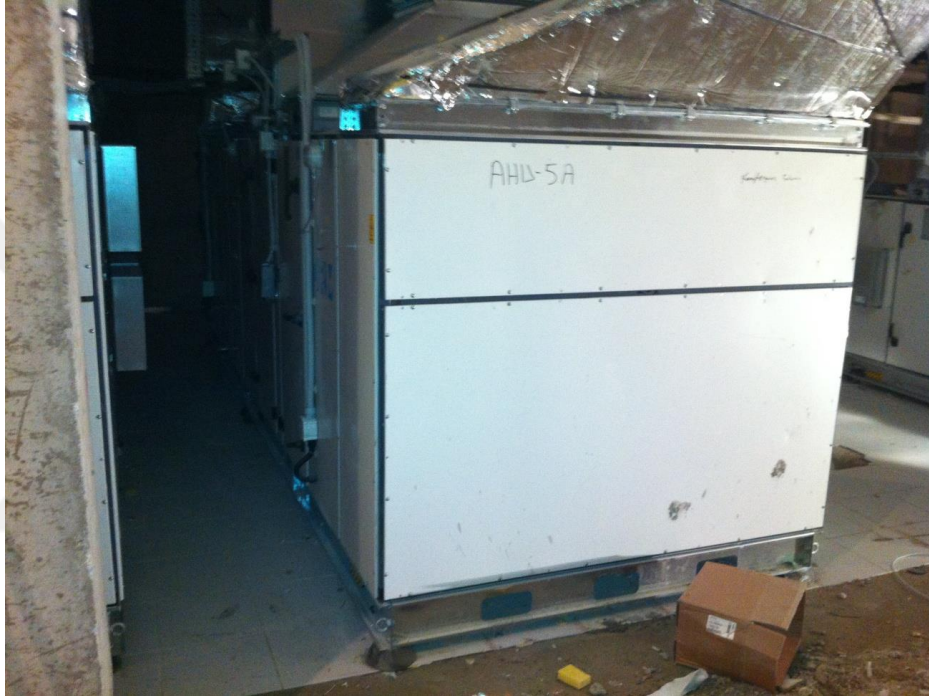
Şekil 4.8. Kullanılan VRF DX klima santral ünitesinin mekanik oda içerisindeki görünüşü
