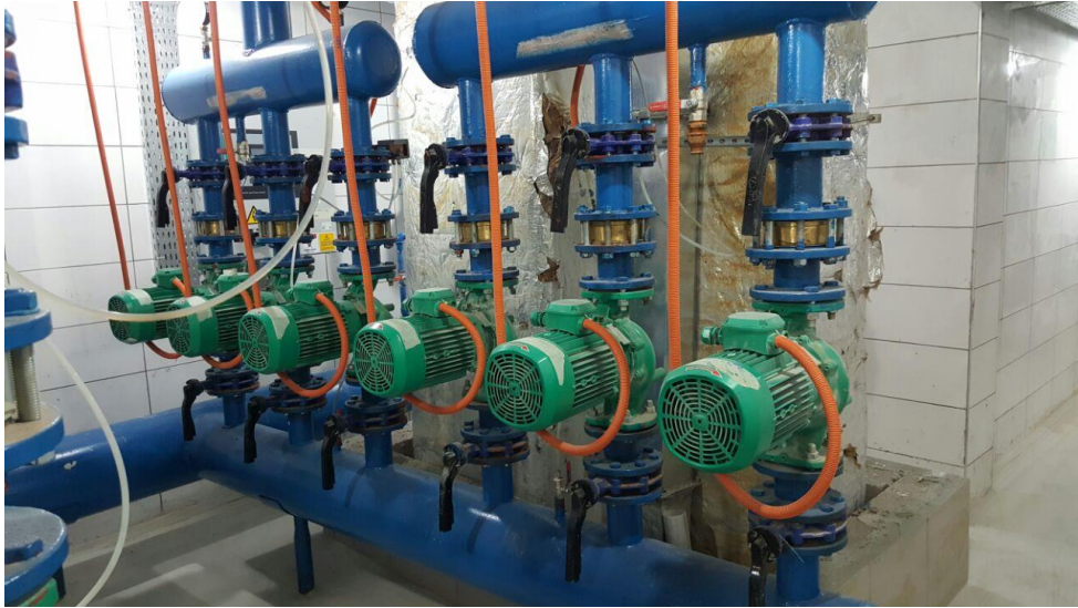
Şekil 4.15. Sistemde kullanılan bölge pompaları ve bağlantısı
