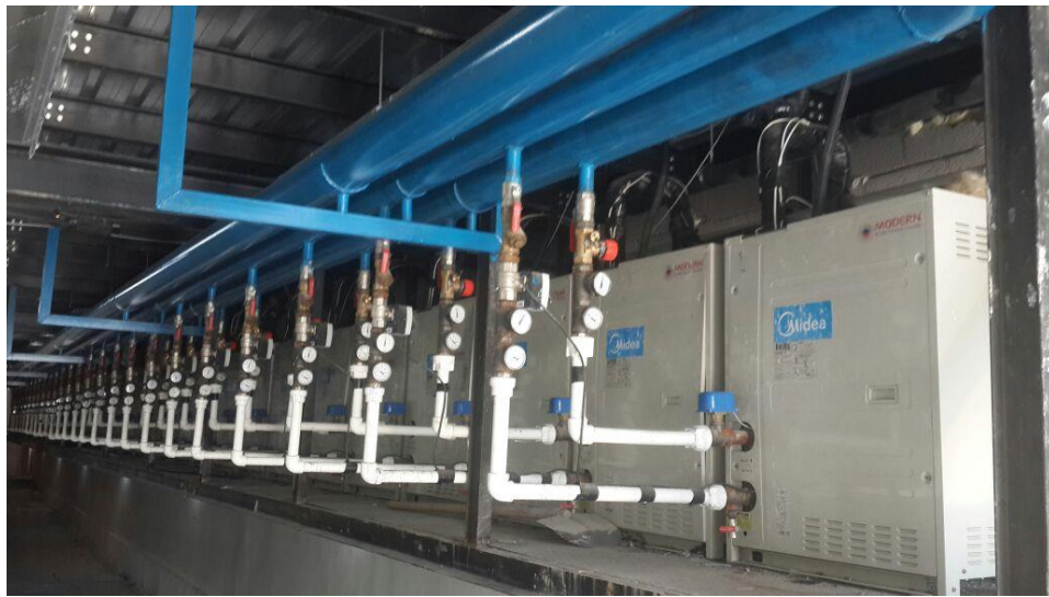
Şekil 4.4. Kullanılan VRF dış ünitenin mekanik oda içerisindeki görünüşü
