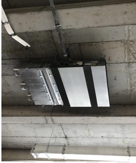
Şekil 4.6. Kullanılan VRF iç ünitenin mekan içerisindeki görünüşü
