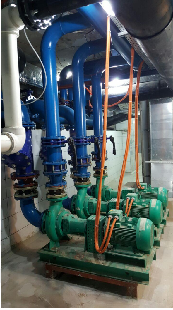
Şekil 4.14. Sistemde kullanılan sekonder devre pompaları ve bağlantısı
